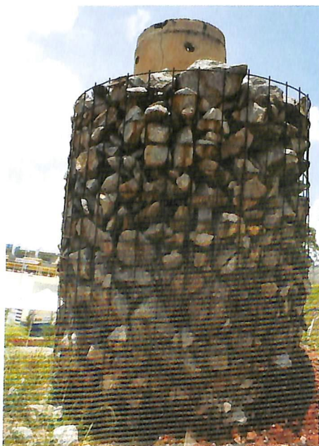
Drenos verticais para captação de gás.
