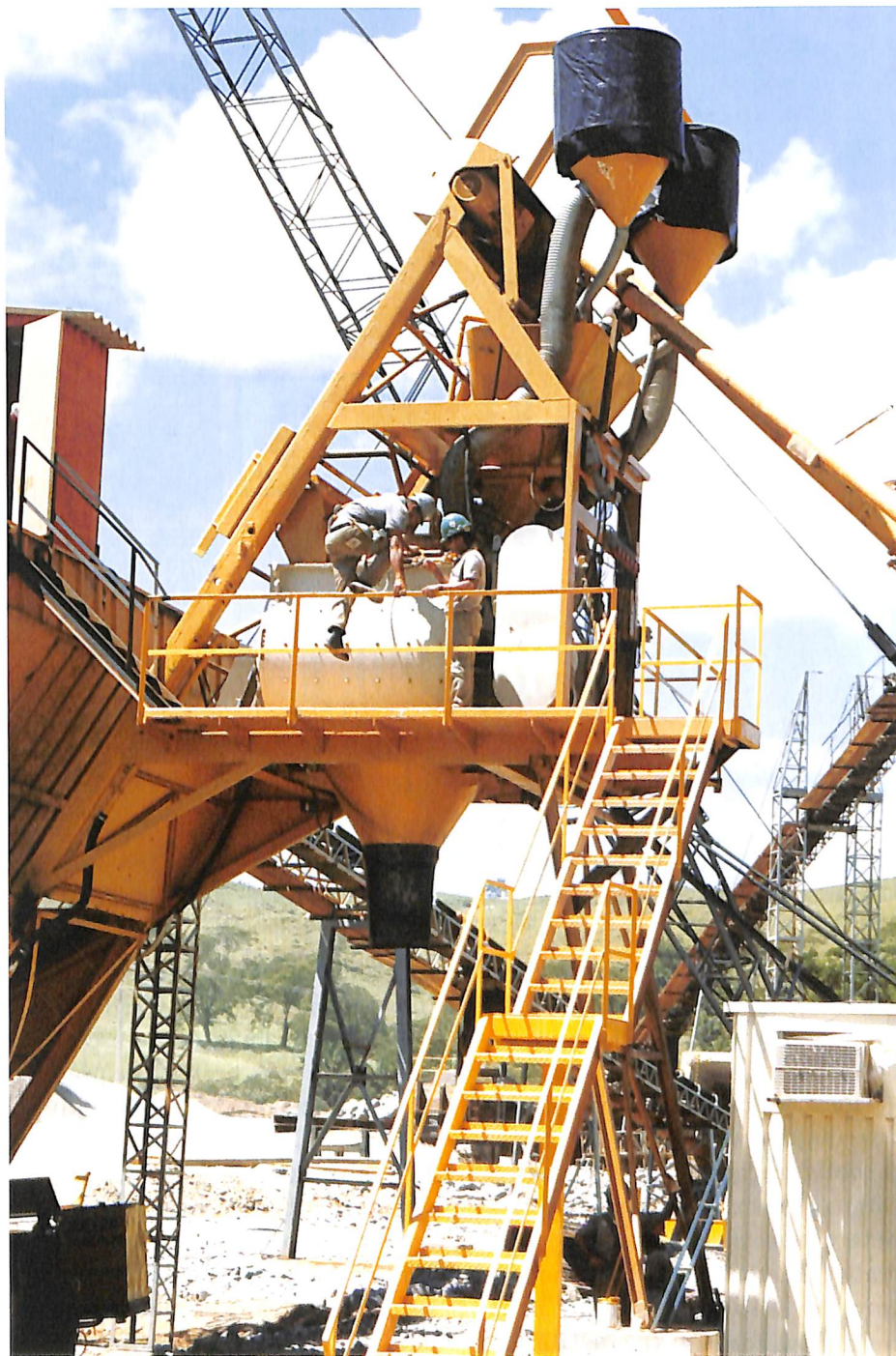
Capim I: fase final de montagem da central de concreto Schwing Stetter para 80 m 3 /h.
