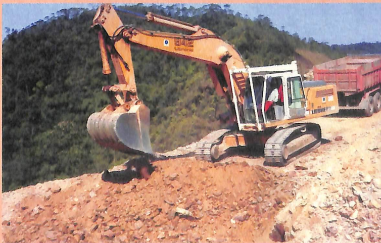
942 e 954: escavação de 510 mil m 3 de solo e rocha Las 942 y 954: excavando 510.000 m 3 en suelo y roca.
