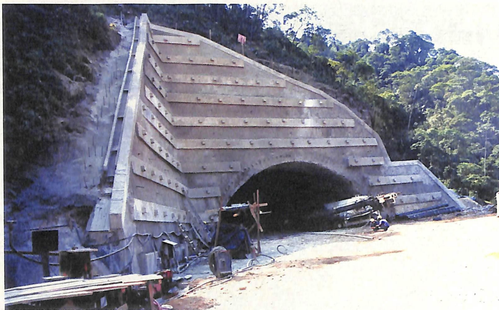
O "portal" do túnel que será escavado em solo La "boca" del túnel que será excavado en suelo.
