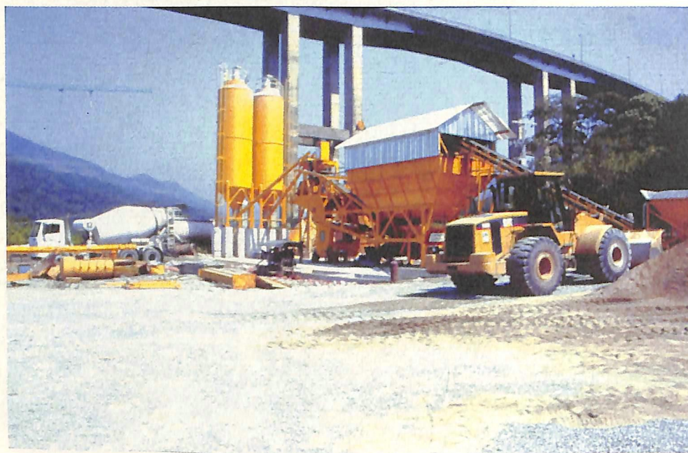
Central de concreto: uma CIBI com capacidade para 90 m 3 /h, e duas "portuguesas" semi-móveis. Planta de hormigón: una CIBI cuya capacidad es de 90 m 3 /h, y dos "portuguesas" semimóviles.
