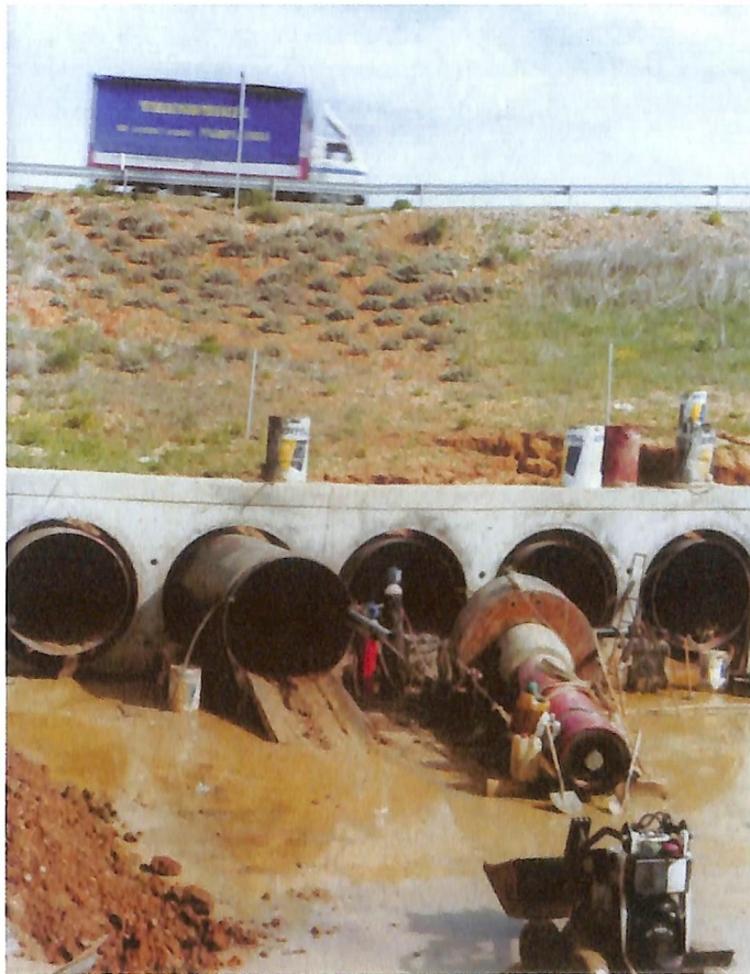
Equipamento Grundoram, da Tracto-Technik: Travessia de tubos com extensão de 75 m sobre rodovia
