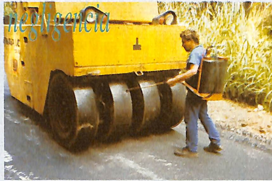
Borriñão de diesel é prejudicial à borracha Pulverização com diesel prejudica el caucho
