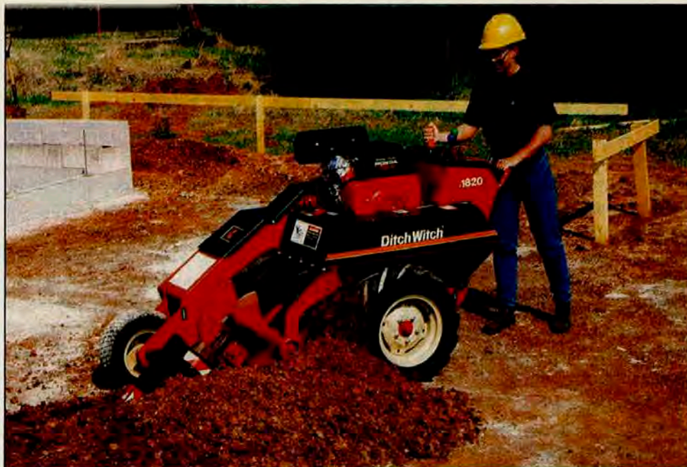
Equipamentos para ampliação de redes
