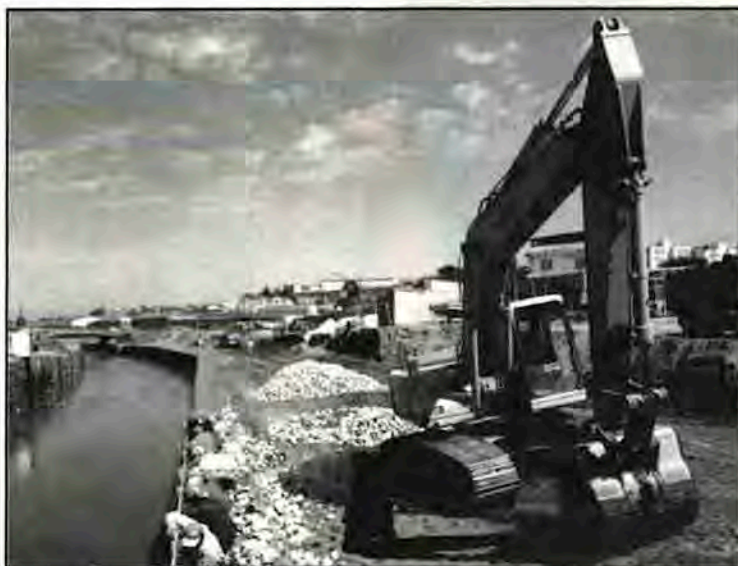
PC 200: Operação urbana na Tecla Transportes e Construções. PC 200: Operación urbana en la tecla Transportes y Contruiciones.
