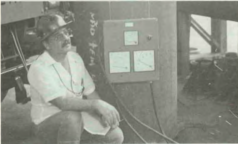
Engº Manoel junto ao quadro de controle da voltagem e amperagem
