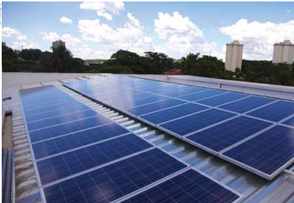
Geração em CC por painéis solares fotovoltaicos só é eficiente se estiverem interligados
