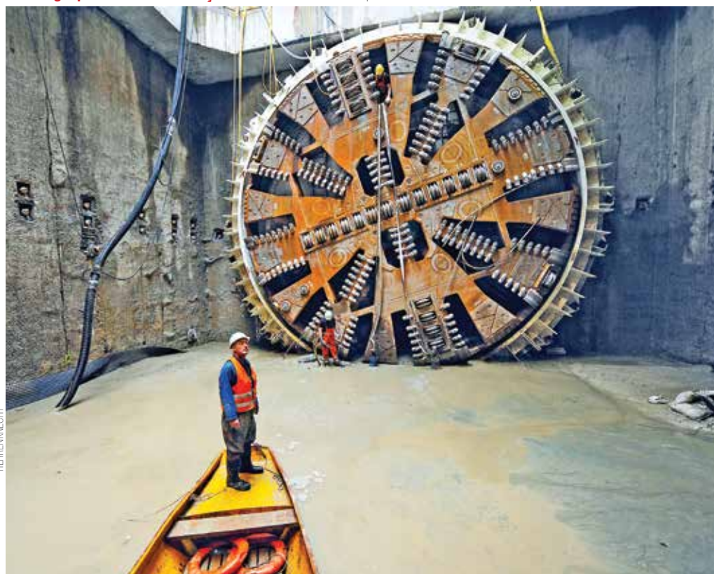
Tecnologia possibilita a construção de túneis sob níveis de pressão antes tecnicamente impossíveis
