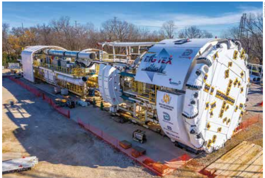
Com 11,6 m, a TBM adaptável é a maior já utilizada em rocha de alta dureza nos EUA
