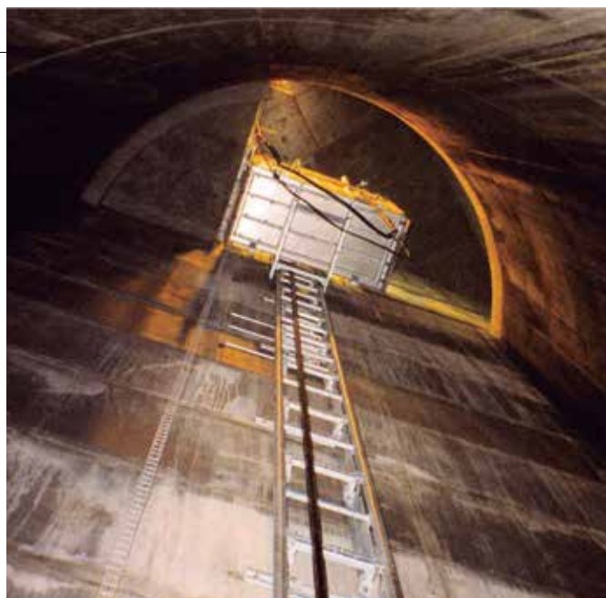
Elevadores industriais conectam níveis em sistemas de túneis
