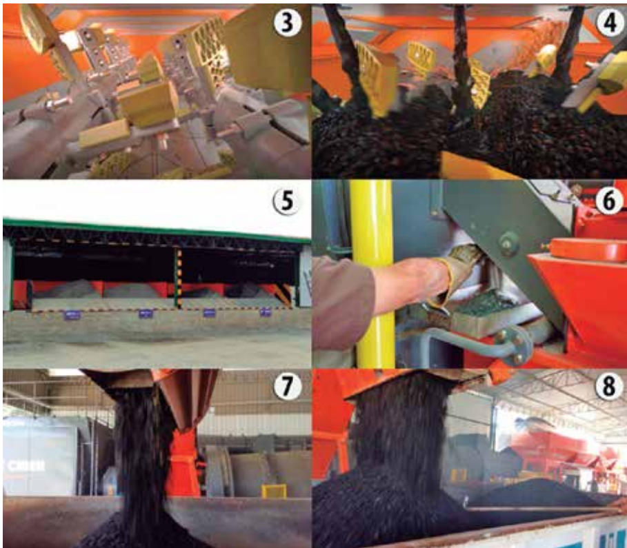
O misturador de uma usina contínua , vazio (3) e cheio de materiais (4), silos dos agregados (5), amostras de agregados secos (6) e saída da massa pronta (7 e 8)
