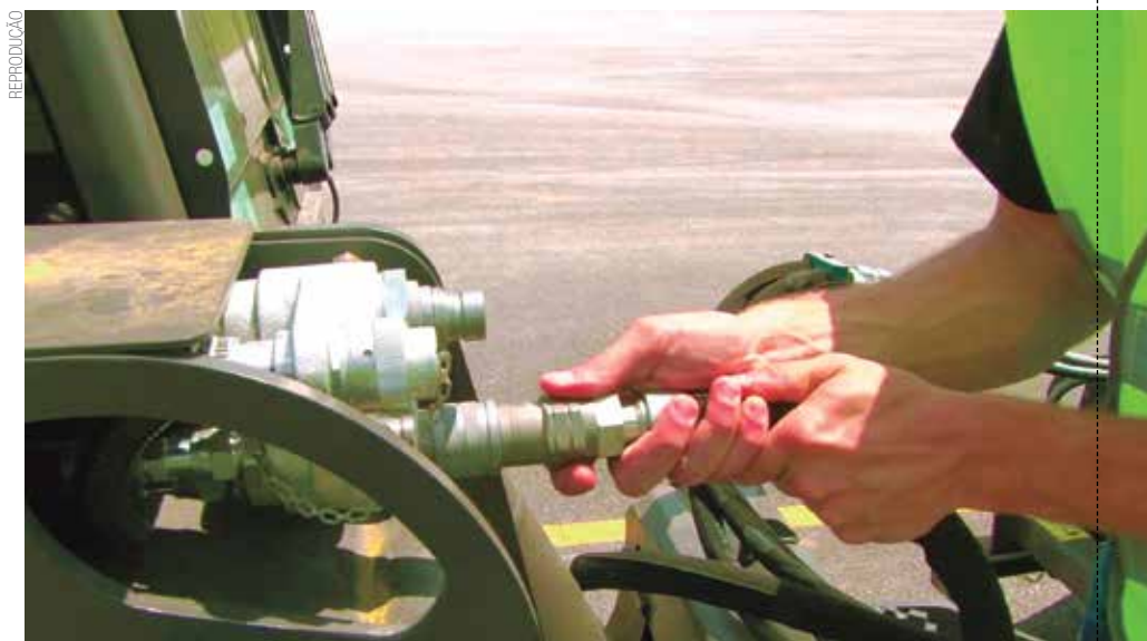
Montagem e fixação dos componentes compõem um dos passos antes de se colocar o sistema em funcionamento
