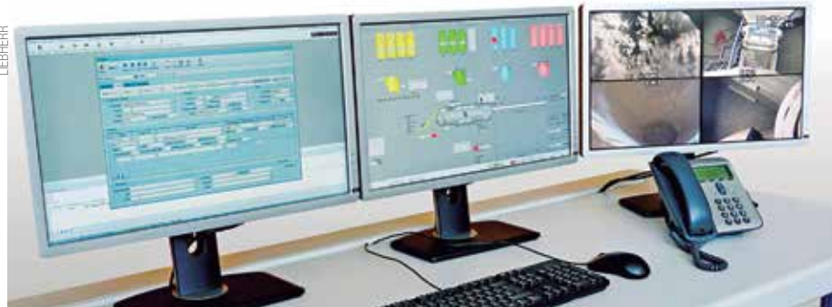
Dispositivos são monitorados pelos sistemas seguindo parâmetros previamente especificados
