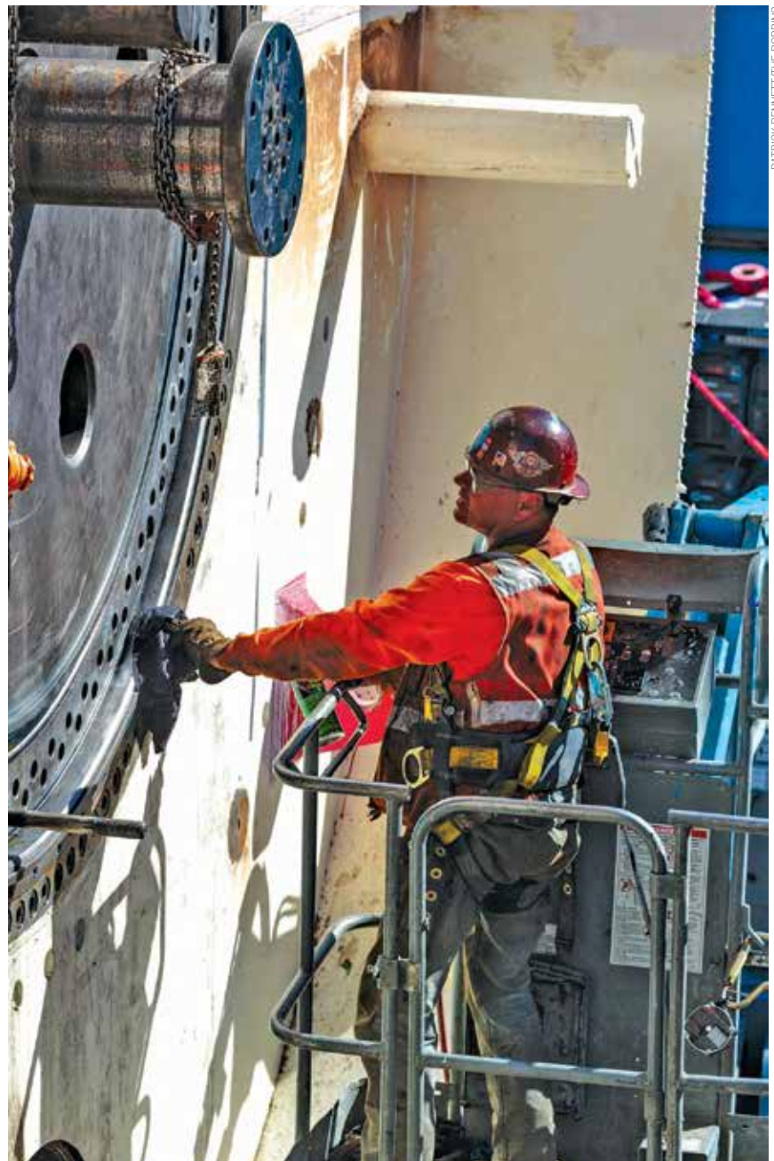
Problemas na cabeça de corte podem paralisar completamente a operação da tuneladora
