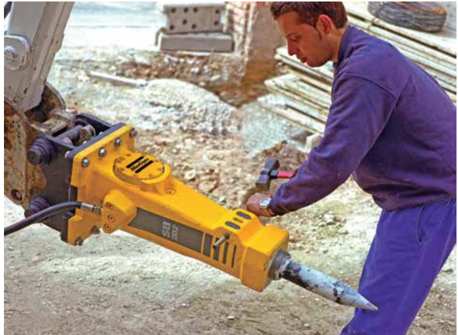
Verificação da regulagem do conjunto é fundamental, pois os parâmetros podem sofrer mudanças
