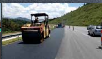
5ª faixa da Rod. Bandeirantes GAP GRADED com ASFALTO BORRACHA (ECO NTA FLEX B)
