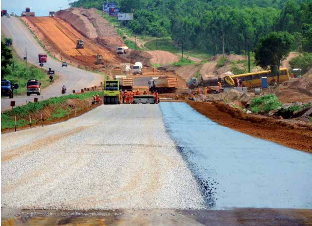
Meta da concessionária responsável pelas obras é duplicar e recuperar 100 km de vias por ano
