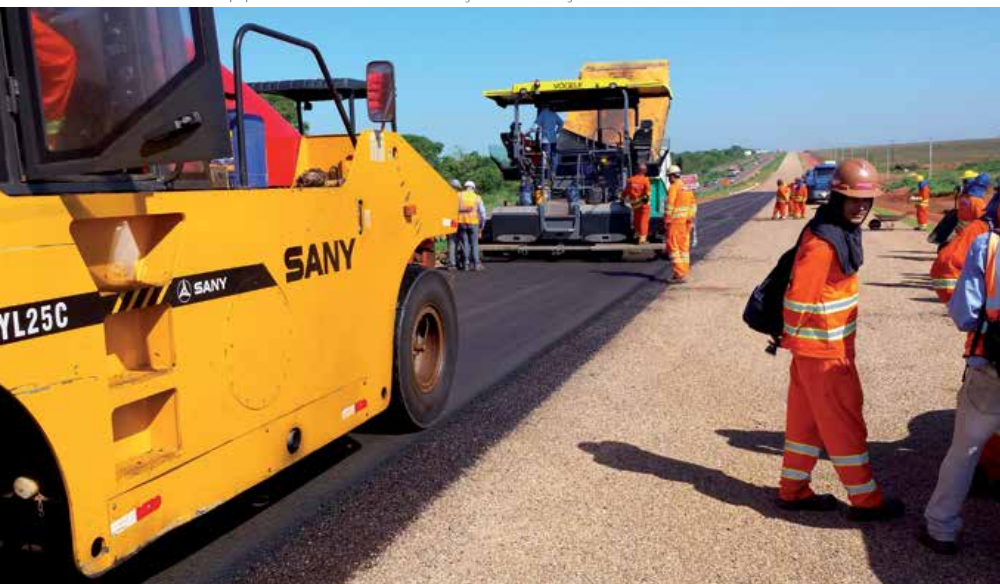
Frota de 567 equipamentos atua na modernização e construção de 450 km da BR-163
