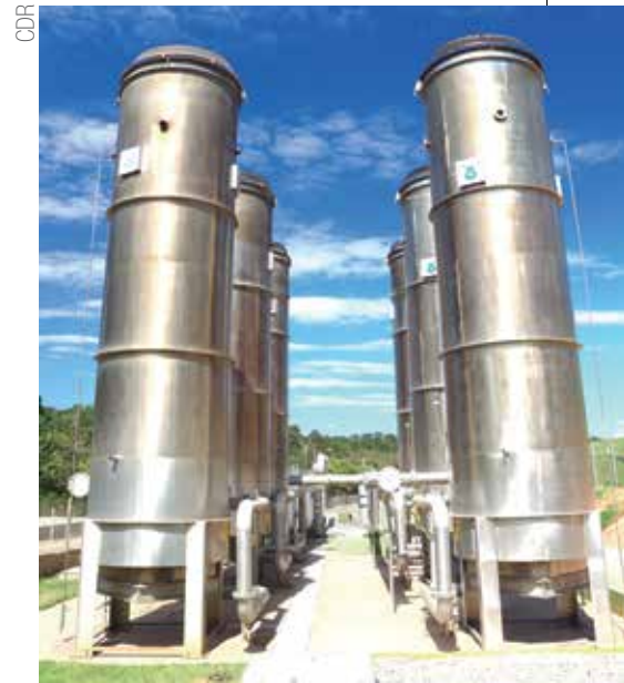
Central de biogás gera energia limpa
