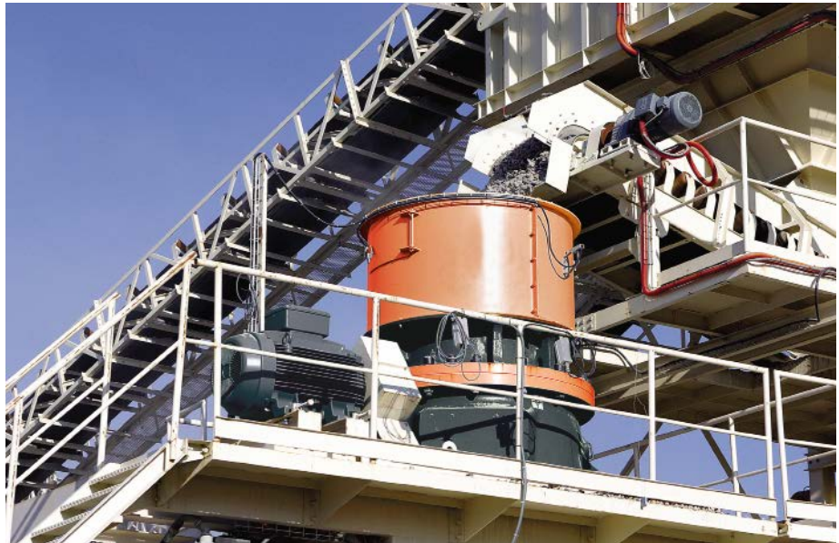
Subida drástica da força de britagem acarreta problemas ao equipamento
