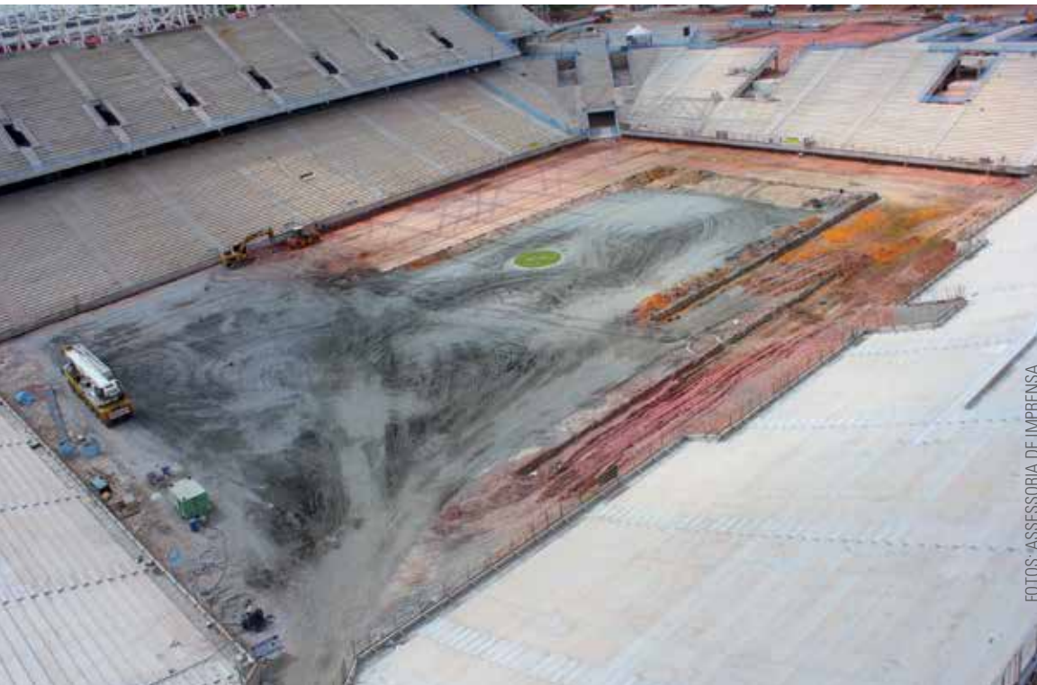
Rebaixado em 50 cm , o gramado do estádio terá sistema de refrigeração e drenagem a vácuo
