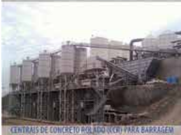
CENTRAIS DE CONCRETO ROLADO (CCR) PARA BARRAGEM
