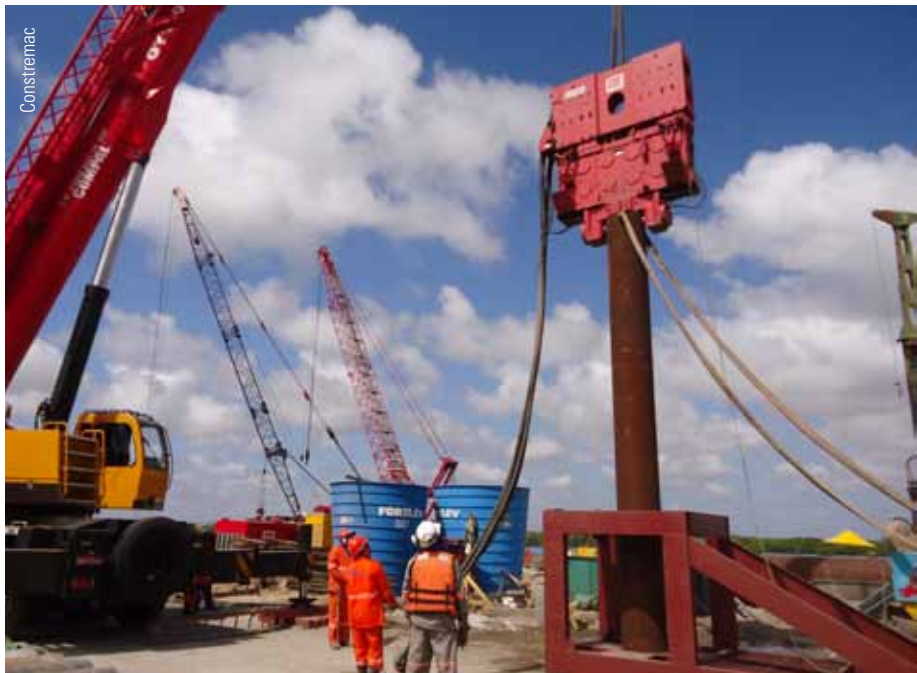
Método inclui armação da estaca e cravação no trecho com camisa perdida
