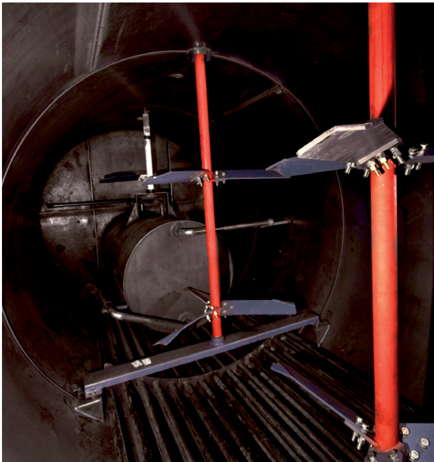
Manutenção de componentes faz a diferença no custo de operação das usinas
