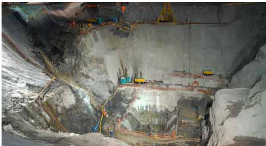
A chegada e saída do equipamento no canteiro exigem um planejamento cuidadoso
