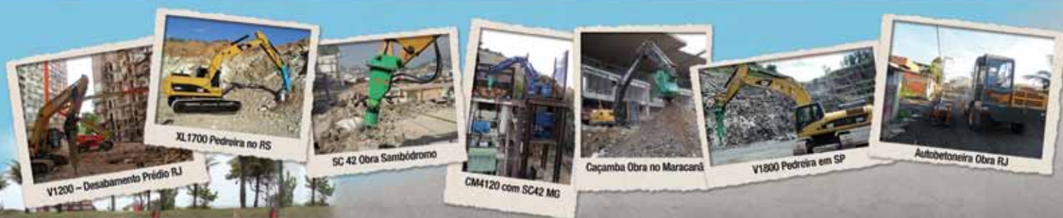
Unidade Hidráulica - Obra Barra da Tijuca RJ
