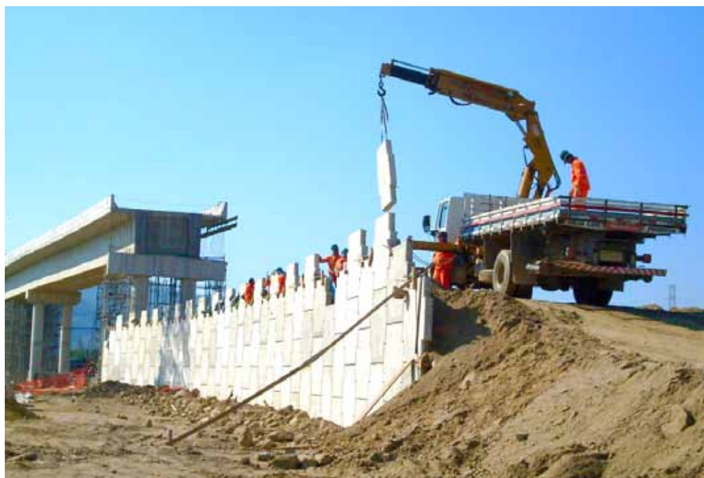
Guindautos não foram projetados para elevar cargas a alturas elevadas
