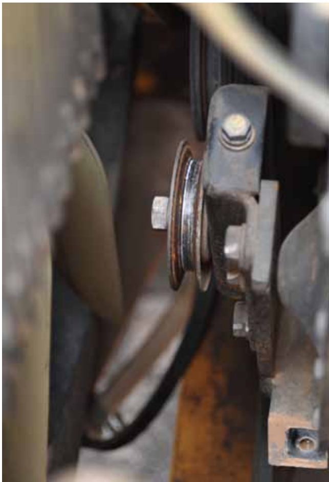
Polia em mau estado pode danificar a correia
