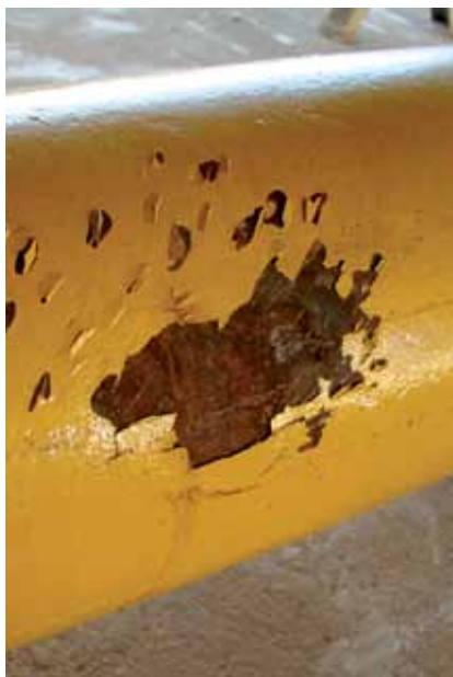
Problemas recorrentes nos elementos estruturais
