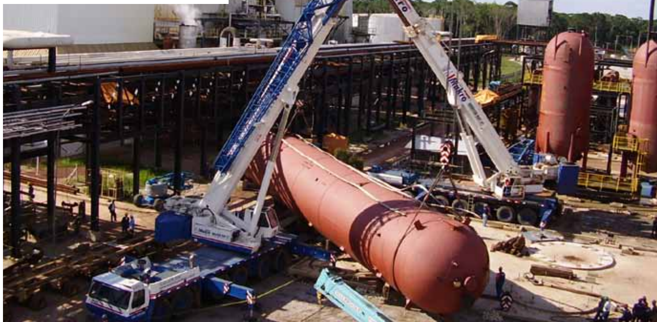
Cuidados operacionais: ao exceder a tabela de cargas do equipamento, o rolamento de giro poderá sofrer danos
