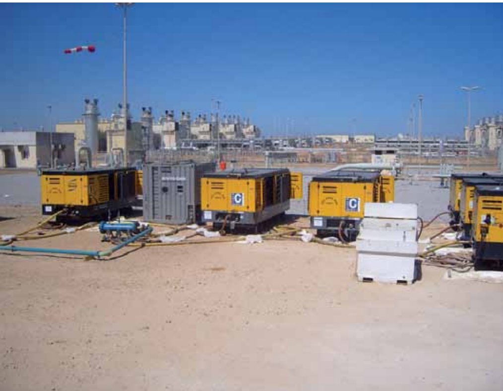
Equipamentos elétricos: menor custo de operação e manutenção
