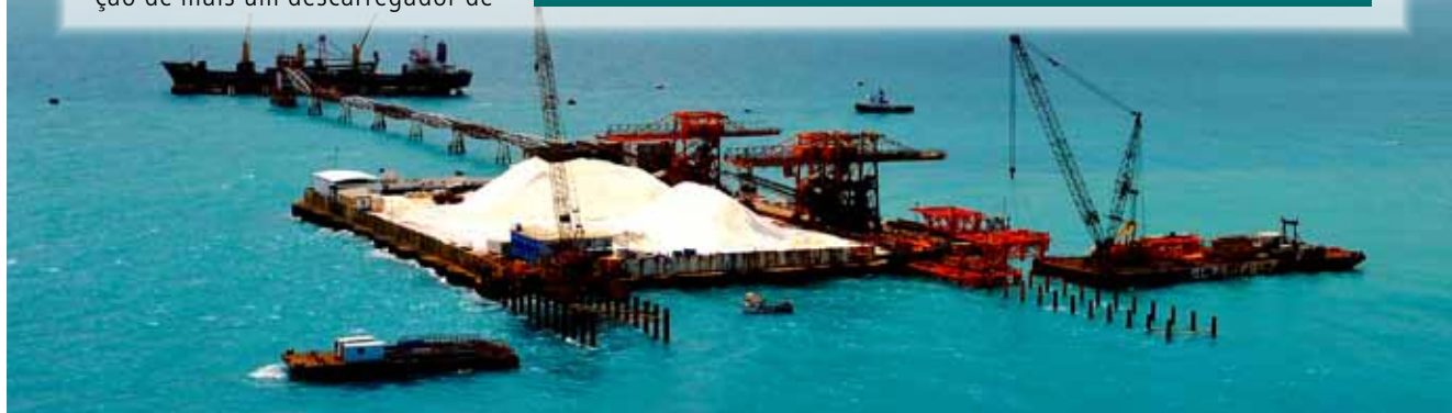
Ampliação da ilha artificial: estacas-pranha formam uma cortina para receber o aterro
