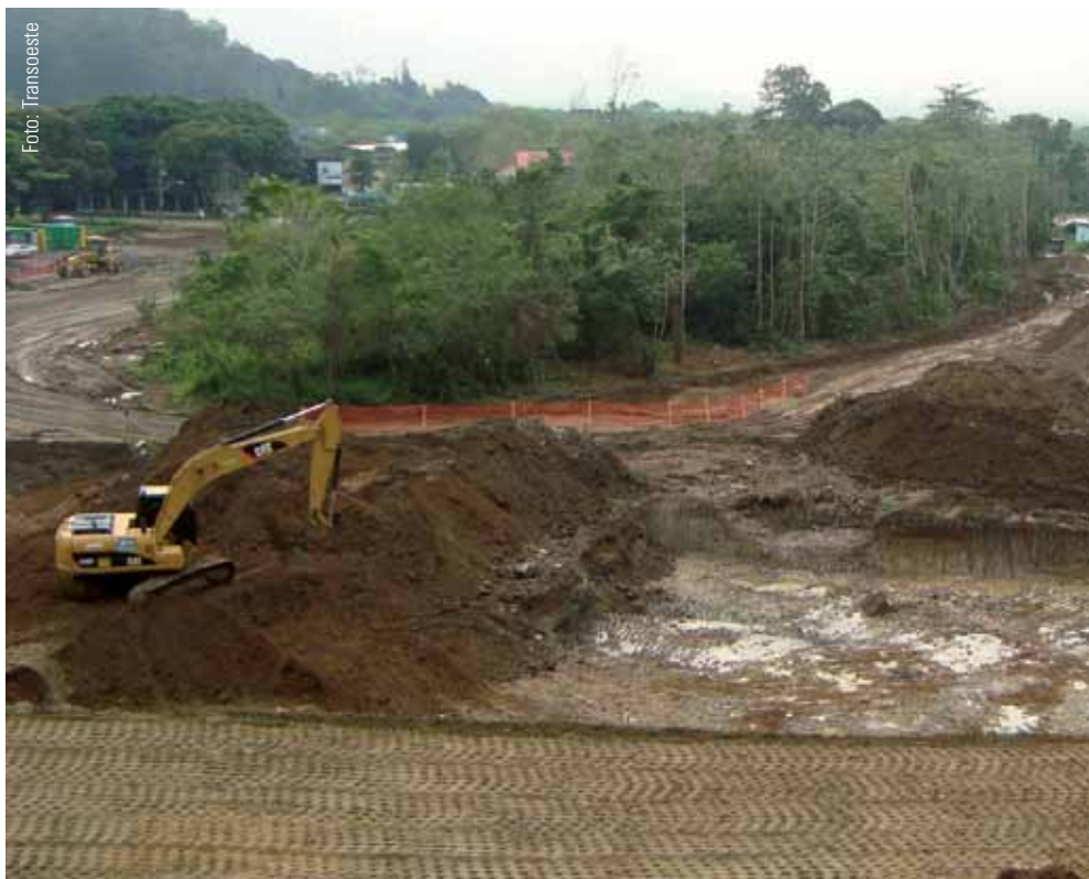
Retirada de solo mole na Transoeste na região do túnel da Grota Funda
