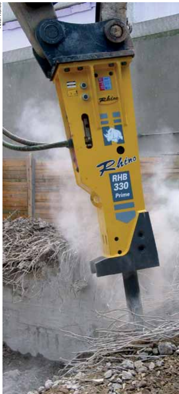
Rompedores da Rhino atuaram na demolição do Estádio da Fonte Nova (BA)
