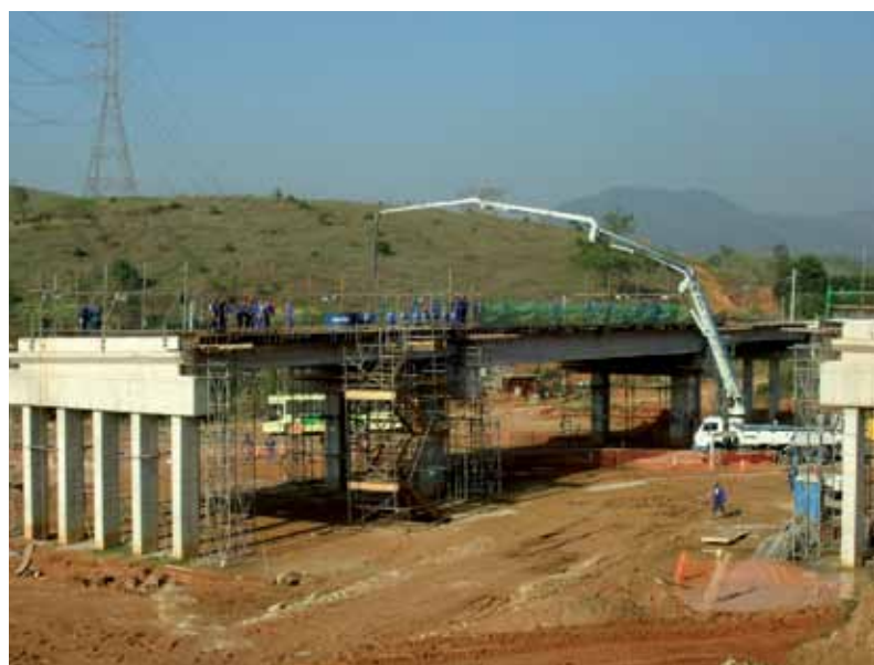
Obras de arte no Arco Metropolitano: 127 unidades entre viadutos, pontes e outras intervenções
