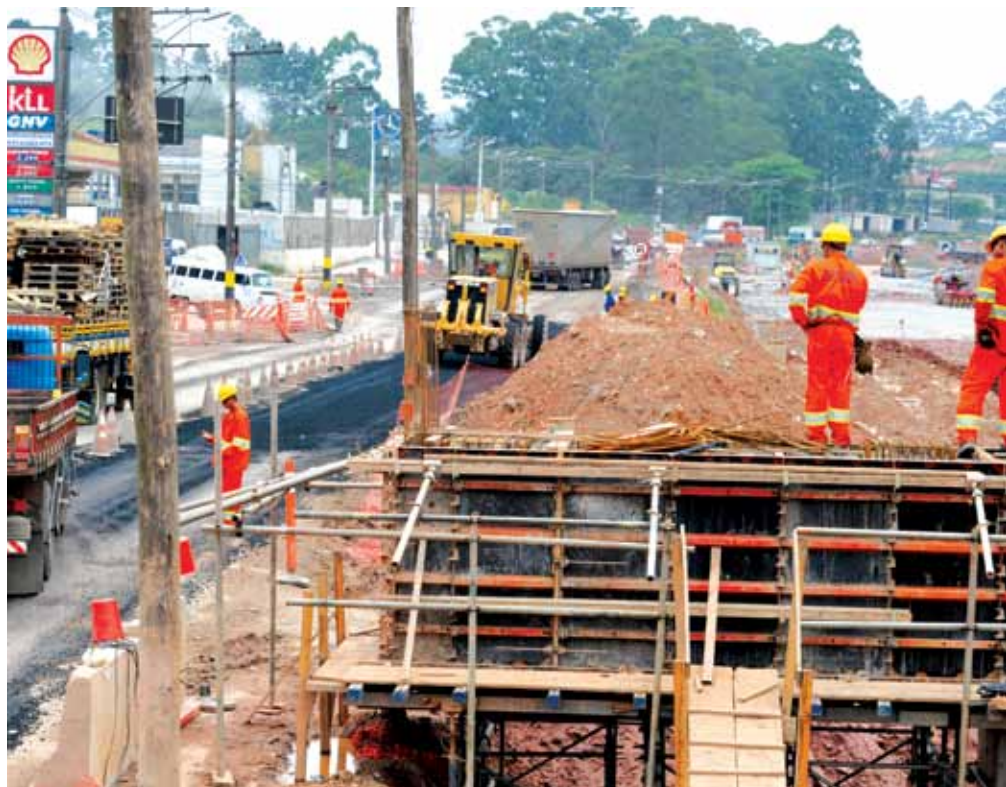
Mesmo com todo o planejamento e logística, obra interfere no cotidiano da região
